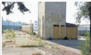
◀ Il luogo La cabina elettrica dell'alta tensione nella quale si è verificato l'incidente a Capurso
